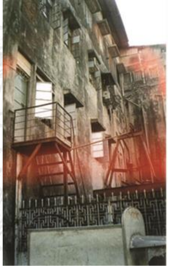
W. N. Elevation Before repairs
